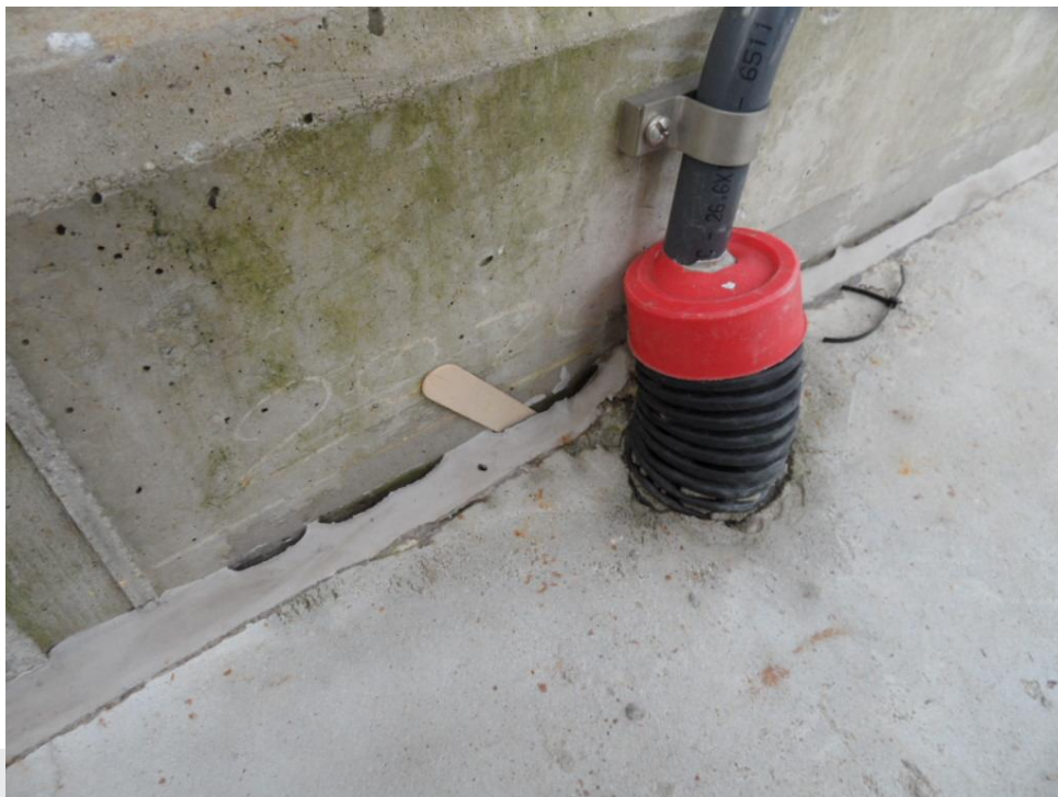
Foto: Gebrek aan afdichting.
